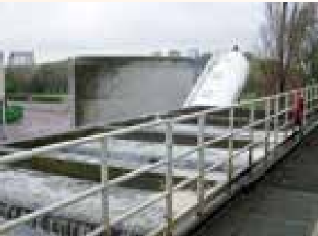
Cellule de filtration.
